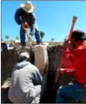
Figura 22: Desprendimiento del monolito.
